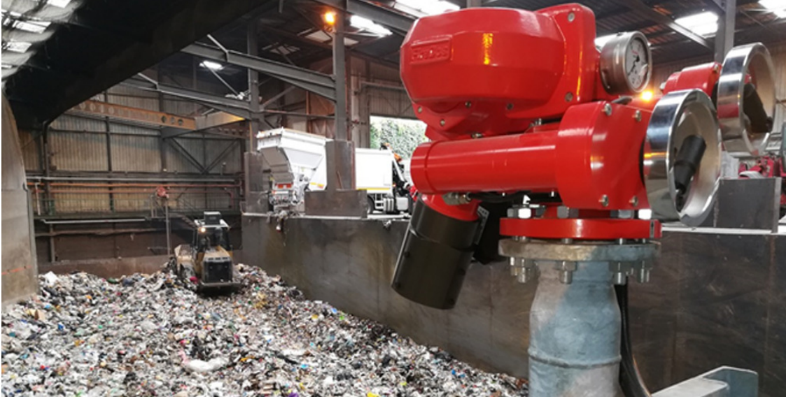
Resim 3. Geri Dönüşüm Tesisinde Bekleme Modunda Manuel Yedeklemeli Uzaktan Kumandalı Yangın Monitörü.
