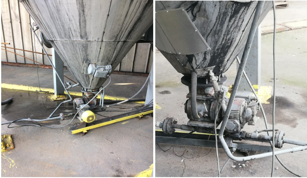
Şekil 6. Silo Depolama ve Enjeksiyon Sistemi
