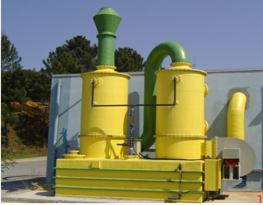
Şekil 7. Klor Nötralizasyon Islak Arıtma Tesisi Görüntüsü
