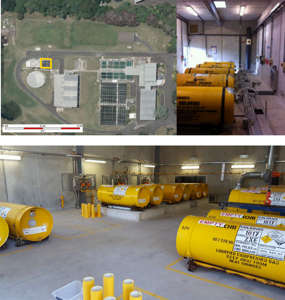
Şekil 1. İçme Suyu Arıtma Tesisi ve Klor gazı Depolama Odası
