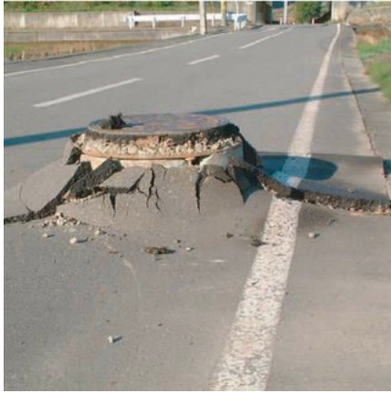
Şekil 1. Sokaklarda Kanalizasyon Bacası Dışarı Doğru İtilmesi
