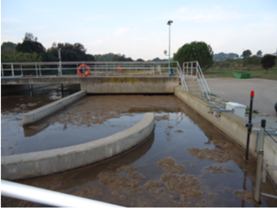
Şekil 13. ÇO ve ORP Sensörlerinin Havalandırma Reaktörlerine Yerleştirilmesi
