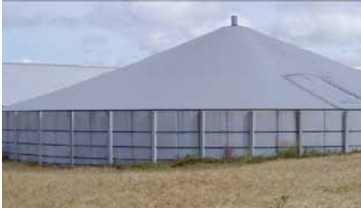
Şekil 7 Gaz Geçirmez Membran (Yumuşak Kapak) İle Kaplanmış, Tankın Kenarlarına Sabitlenmiş Dijestat Depolama Tankı
