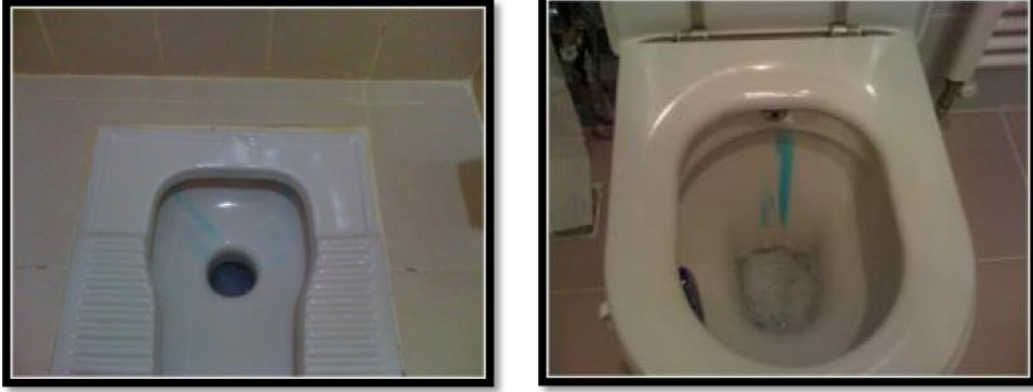
Şekil 3-4 Su Sızdıran Tuvalet
